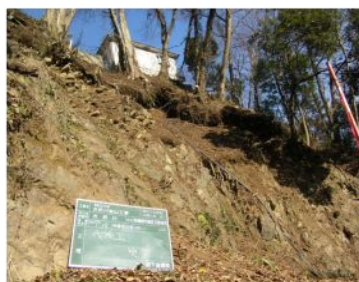
崩落状況（施工前）
